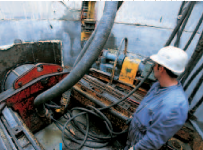
Sogea Construction maîtrise toutes les techniques de pose, ici par microtunnelier à Villenave-d'Ornon.
