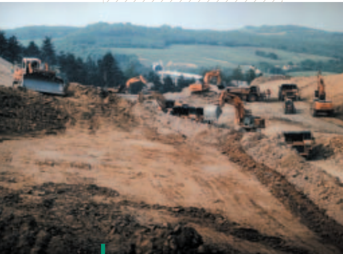
Terrassements A89 : Deschiron a réalisé une grande partie des terrassements de l'autoroute A89, qui reliera Bordeaux à Clermont-Ferrand.
